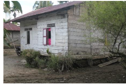
Gambar 6. Rumah Non Panggung Mengalami Kegagalan Struktural
